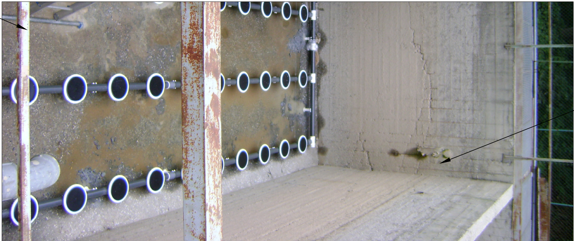
VISTA DELLE CONDIZIONI ATTUALI DEL CIS E DEI FERRI DI ARMATURA DELLE VASCHE DI OSSIDAZIONE
